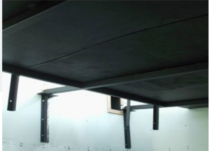
DETALLE DE SOPORTES DEL COLECTO Y COLECTOR.
