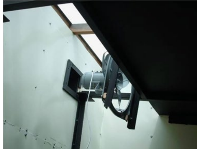
UBICACIÓN E INSTALACIÓN DEL VENTILADOR.
