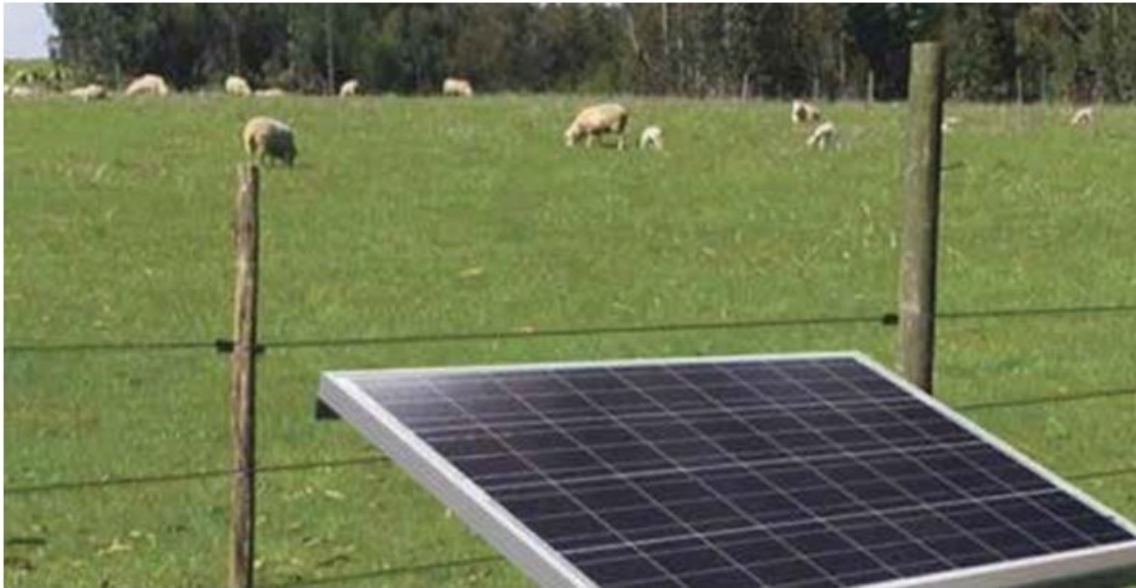
FIGURA 18. CERCA ELÉCTRICA SOLAR. (Imagen: modificado de saecsaelectro.com).
