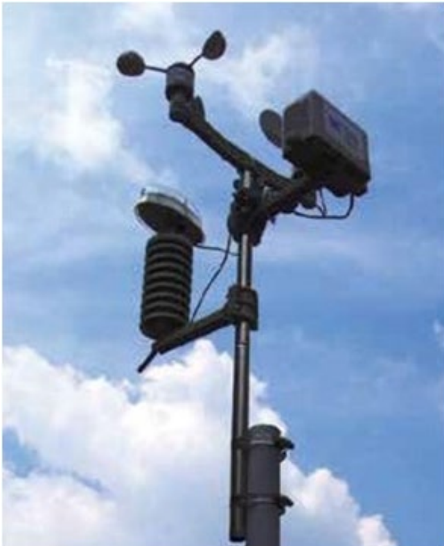
FIGURA 34. ESTACIÓN METEOROLÓGICA INSTALADA EN LA LECHERÍA DEL ITCR-SSC (SANTA CLARA) PARA MONITOREAR LA POTENCIA SOLAR QUE INCIDE SOBRE LA SUPERFICIE.
